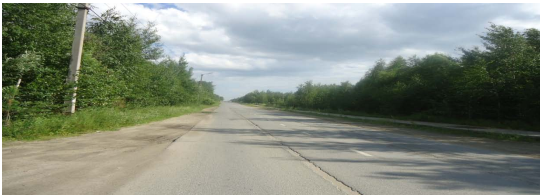
Рисунок 12. Улица Вахская. Отсутствие бордюрного камня, водоотвода с поверхности проезжей части, дефекты покрытия. Требуется обустройство остановок общественного транспорта.
