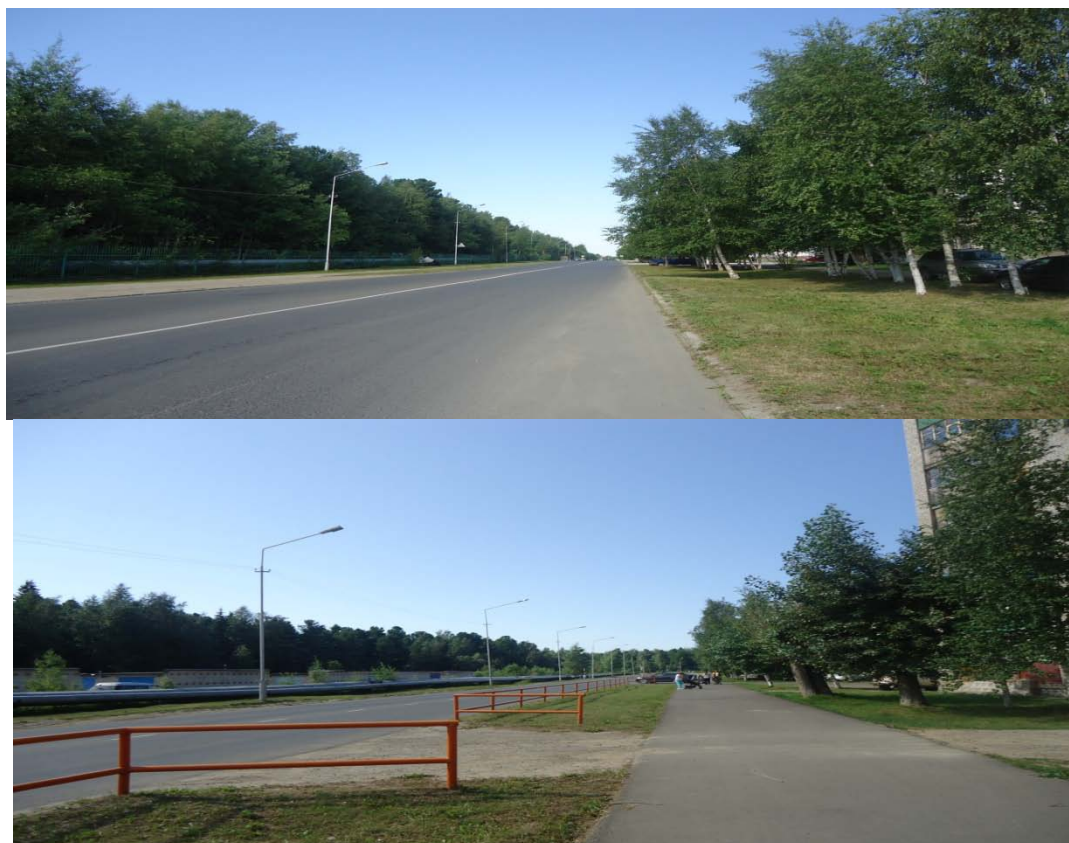
Рисунок 11. Улица Мира. Наблюдается износ, отсутствие бортовых камней, износ участка тротуара вблизи ул.Ермакова
