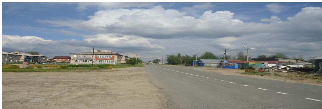
Рисунок 12. Улица Викулова. Отсутствие бордюрного камня, водоотвода с поверхности проезжей части, дефекты покрытия. Требуется обустройство остановок общественного транспорта.
