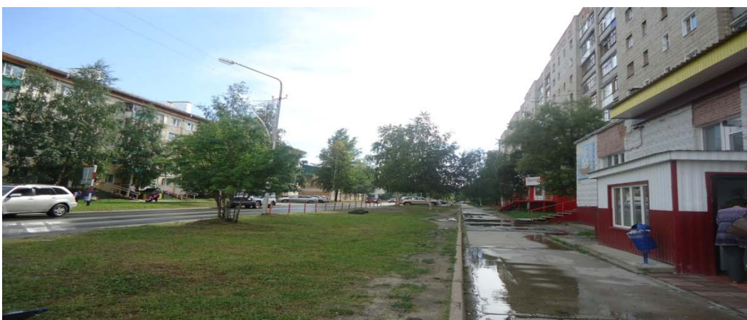
Рисунок 11. Улица Ермакова. Наблюдается износ дорожной одежды проезжей части, тротуаров, бортовых камней. Требуется замена ограждений.
